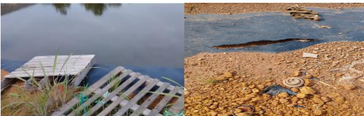
Figura 29 – Paletes empilhados proximo a uma lateral da vala de de Lagoa de Chorume. Geomembrana danificada na vala de RSD, possível contaminação do solo e lençol freático.
