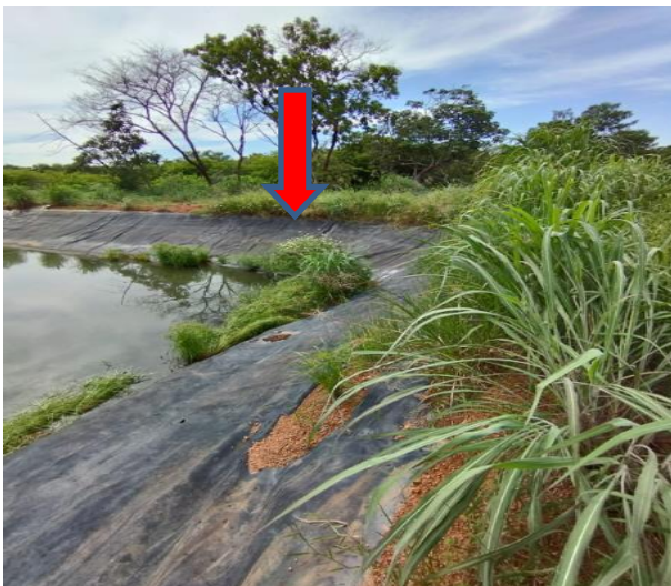
Figura 19 – Observa-se crescimento vegetativo dentro da lagoa de chorume indicando que a manta geomembrana está danificada, possível contaminação do solo e lençol freático.
