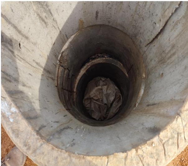
Figura 21 – Drenos degás da vala de RSD cobertos por begues, prejudicando a eficiência do sistema, afirmando a falta de manutenção do mesmo.
