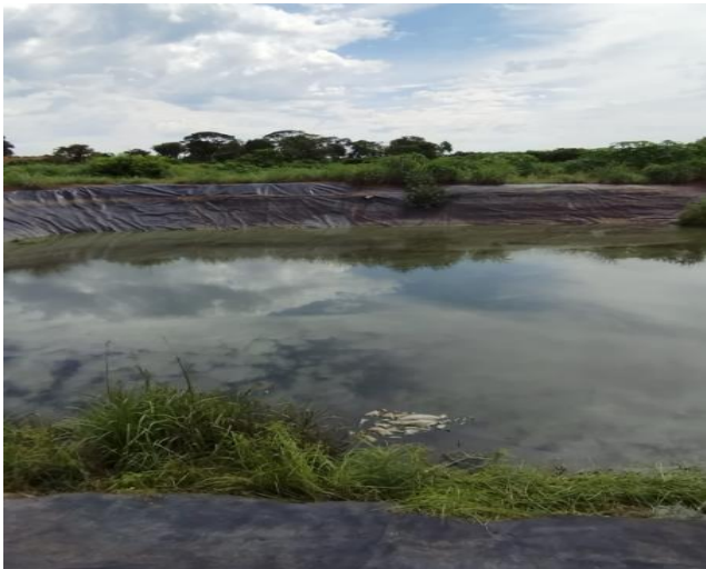
Figura 18 – Falta de manutenção e limpeza nas laterais da lagoa de chorume. Observa-se crescimento vegetativo dentro da lagoa indicando que a manta de geomembrana está danificada, possível contaminação do solo e lençol freático.
