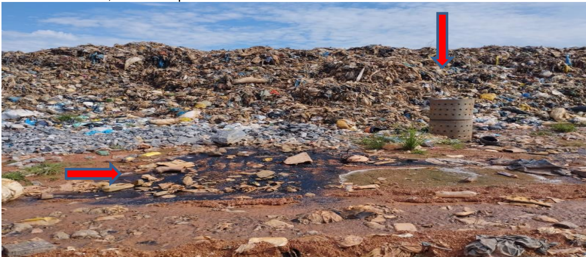
Figura 25 -Vala RSD em operação inadequada, falta de compatação e cobertura, além do sistema errado de disposição, aparentemente o sistema de drenagem de chorume não está eficiente, devido ao acúmulo do mesmo dentro da vala. Observando os drenos de gás podemos dizer que não estão de acordo com as normas.
