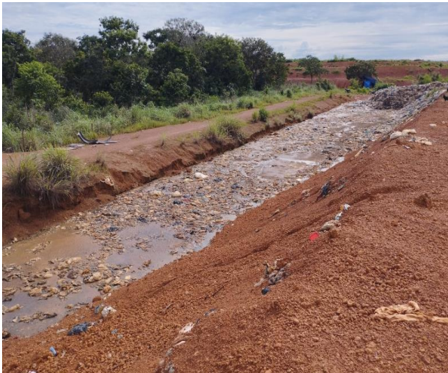
Figura 22 – Chorume dentro da vala de RSD, ineficiência da operação e do sistema drenagem é visível o extravazamento da caixa da vala de RSD em operação, possível contaminação do solo e do lençol freático.
