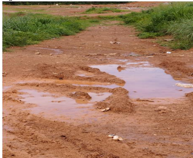
Figura 14 – Falta de manutenção nas vias internas de acesso as valas do aterro sanitário de Gurupi.
