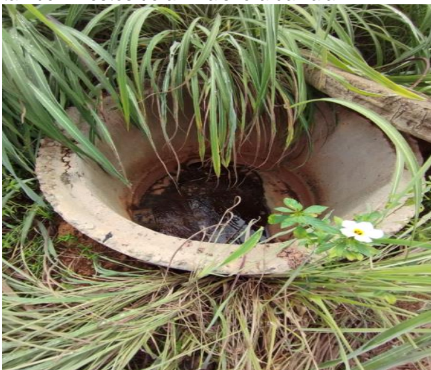
Figura 17 – Falta de limpeza e cobertura nos postos de passagem de drenagem do chorume.
