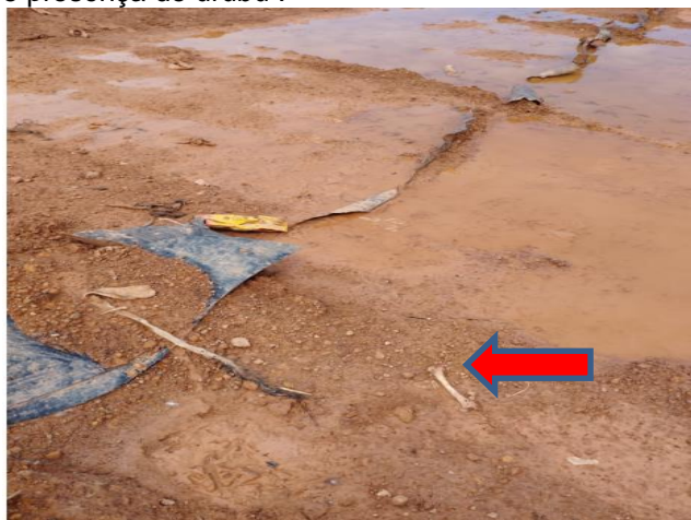
Figura 16 – Falta da preservação do revestimento da vala (manta geomembrana de impermeabilização) nota-se também restos de animais fora da vala.
