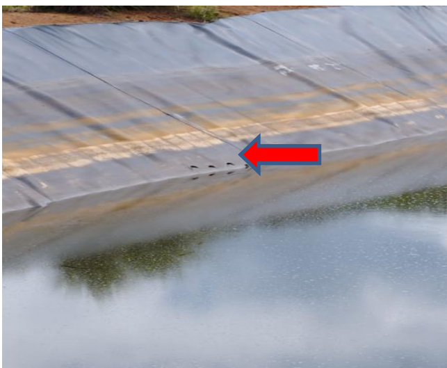
Figura 20 – Lagoa de Chorume geomembrana danificada.
